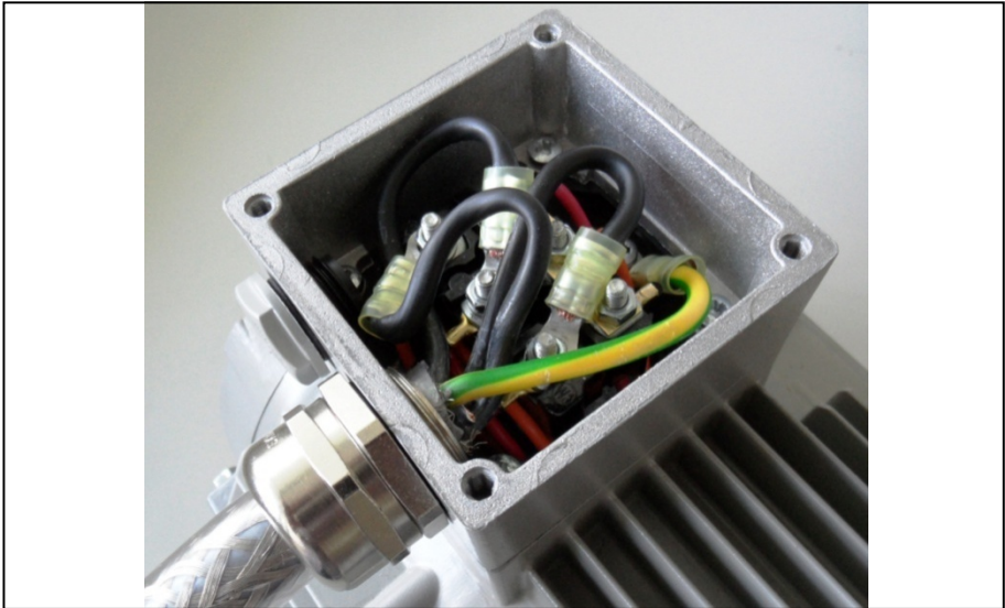
Abb. 22: Verdrahtung am Motoranschlusskasten
